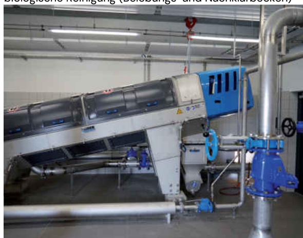
Klärschlammbehandlung und Entwässerungsanlage
