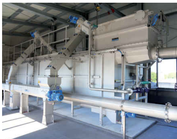
mechanische Reinigung (Rechen- und Sandfang)
